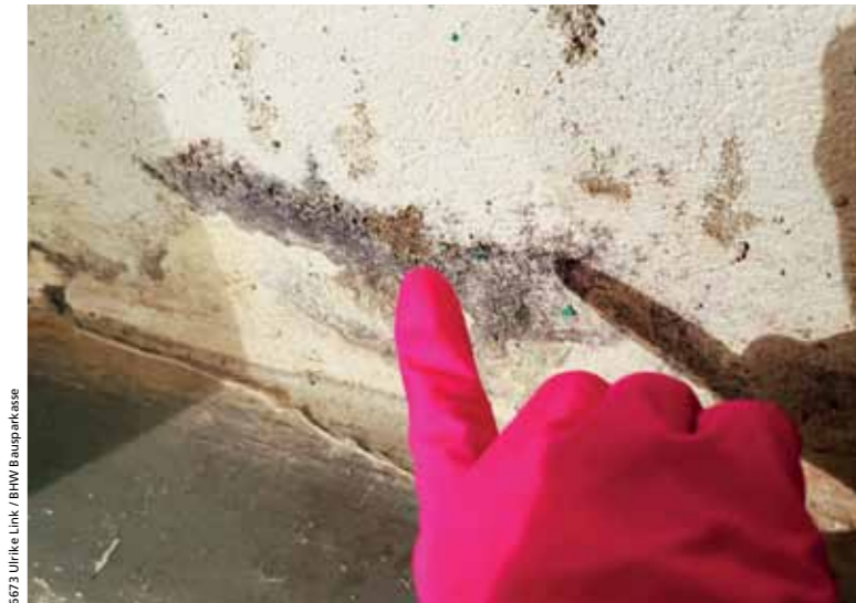
Ein Fall für Fachleute: Schimmel an der Wand kann krank machen
